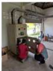
7.7 ติดตั้งระบบไฟฟ้าสำรองดีเซลสูบน้ำ
